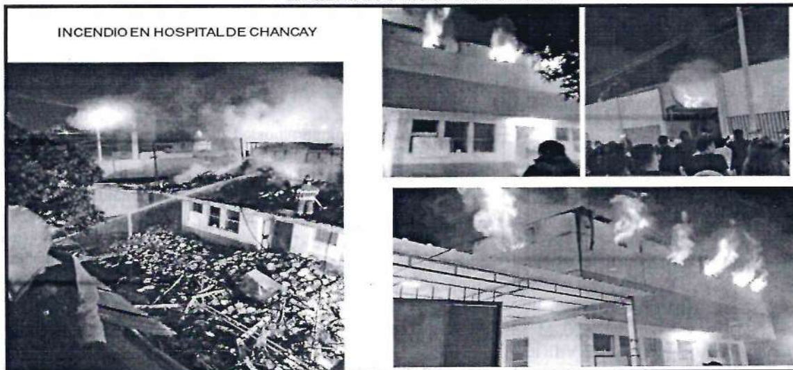
Incendio afectó el área COVID-19 del segundo piso del hospital de Chancay. De acuerdo al portal del cuerpo General de Bomberos Voluntario del Perú (Cgbvp), nueve unidades llegaron para atender la emergencia desde las 11:19 p.m. del miércoles 16 de febrero.
